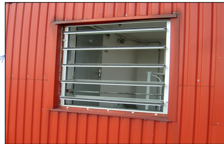
Otvorenie vetracej žalúzie schodiska
