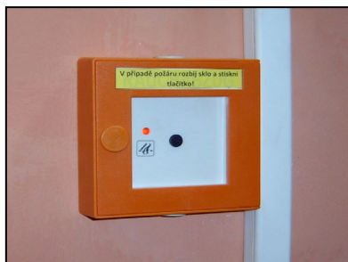
Tlačidlový hlásič na každom podlaží schodiska
